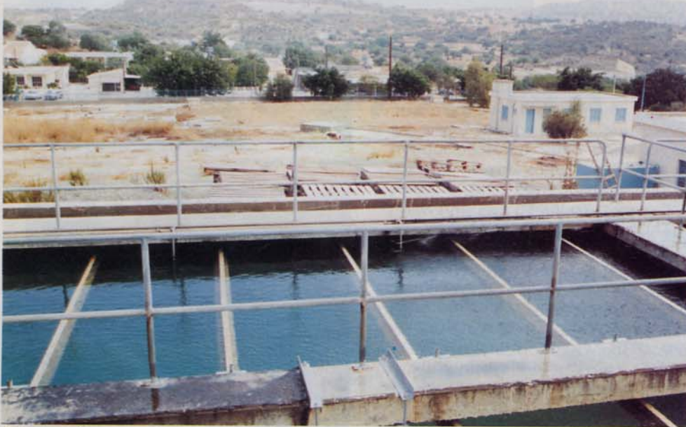
Δεξαμενή κατακαθίσεως στο διυλιστήριο της Χοιροκοιτίας. Στο βάθος η υπόγεια δεξαμενή του καθαρισμένου νερού που διοχετεύεται στην κατανάλωση.
